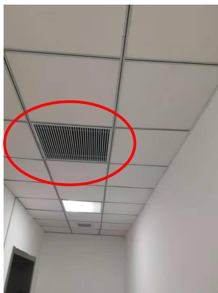
图 4-9 后装治疗机房内的排风口
