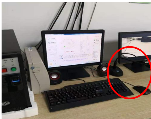
图 4-5 后装治疗机房对讲系统
